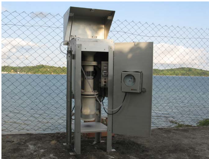
Figura 18. Amostrador tipo PTS instalado em Bananeira (Ilha de Maré).
