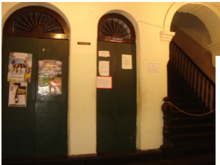
Foto 3: Entrada principal com escada interditada.
