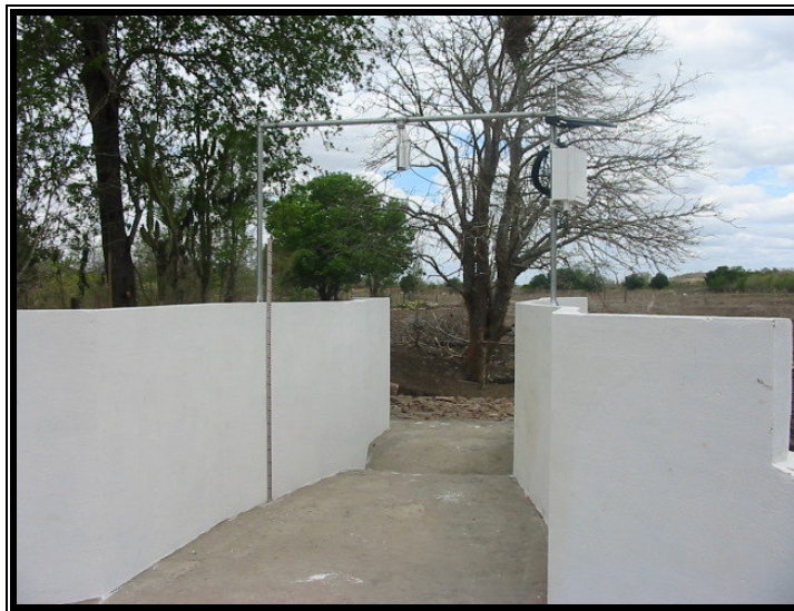
Figura 15: Calha Parshall 5' e linígrafo de ultrassom
