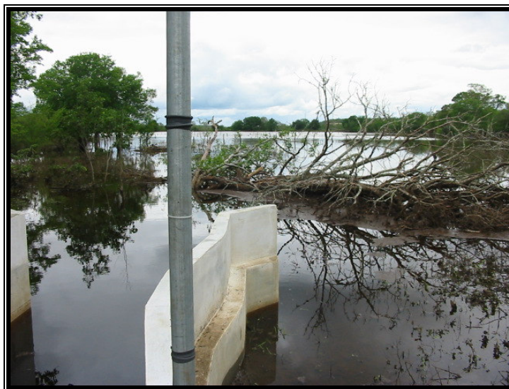
Figura 20: Calha Parshall 5' danificada
