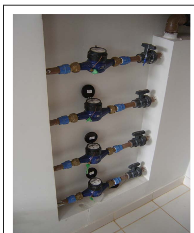
Figura 3.6 – Instalação de hidrômetros individuais em hall de entrada de condomínio
