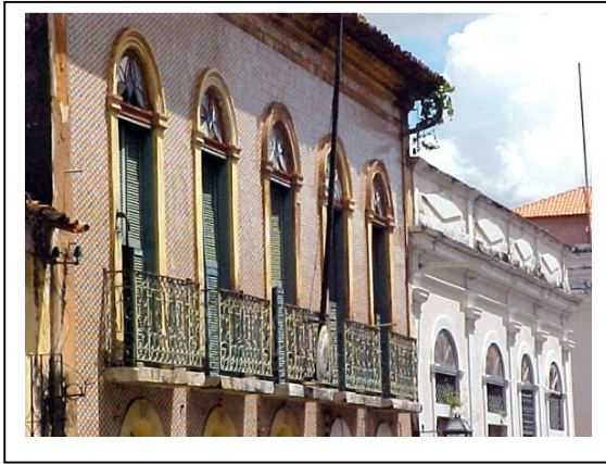
FIGURA 7.20: Sobrados à Rua 14 de Julho : Mudar sua estrutura interna para garantir economicamente a sua preservação ou deixar ruir? (São Luiz, Maranhão, Foto: E. Abrahão, fonte: www.patrimonioslz.com.br )
