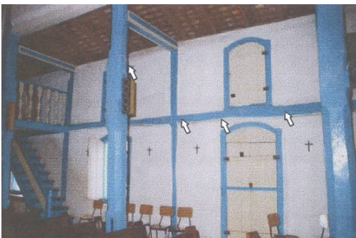
FIGURA 6.15: Restauro da Igreja São Sebastião de Araxá: Admite-se o uso de modelos análogos para complementação, como é o caso do forro local, sem registro histórico, mas que seguirá, por analogia, o forro de uma igreja similar de uma cidade próxima. (Foto: Ionei Dutra)
