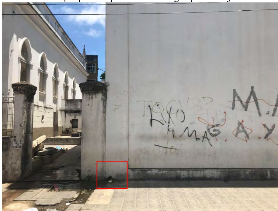
Figura 193 –Vista de um trecho da fachada sudoeste do bloco anexo, em destaque a tubulação pluvial que direciona a água para a sarjeta.
