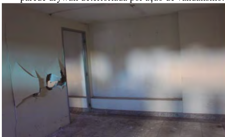
Figura 122 – Vista interna do ambiente do porão alto onde é possível enxergar a parede drywall deteriorada por ação de vandalismo.
