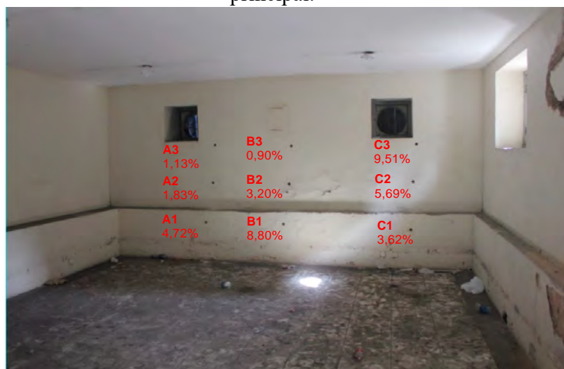
Figura 331- Mapeamento das amostras do teor de umidade do porão alto do bloco principal.
