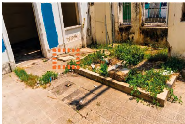
Figura 194 – Trecho da fachada noroeste do bloco anexo do edifício da antiga Intendência. Em destaque a caixa de inspeção de esgoto sanitário com tampa em concreto.
