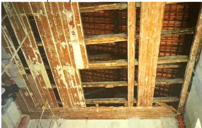
Figura 60- Vista do forro do pavimento térreo do bloco principal. Observa-se a remoção da pintura e das tábuas danificadas.
