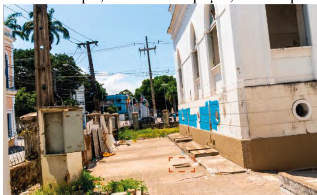
Figura 139 – Trecho da fachada sudoeste do bloco principal do edifício da antiga Intendência. Em destaque, a caixa de inspeção, sem tampa de proteção.
