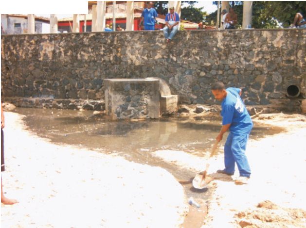
Foto 122 - canalizando vazamento ao mar, sereia
