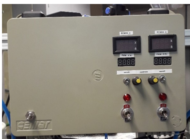
Figura 3.15 Painel de Controle das Bombas e Bicos Injetores.
