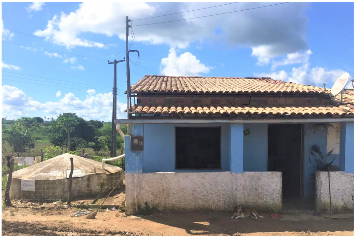
Figura 25 – Abastecimento de água
