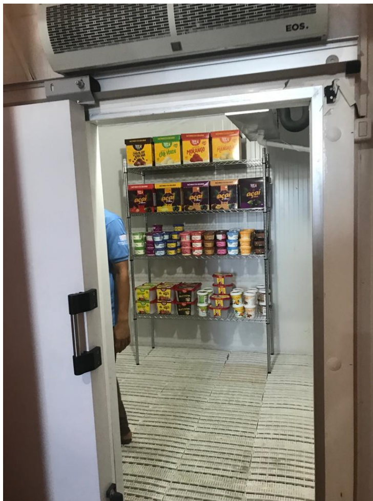
Figura 13: Fotografia da câmara fria no Museu do Sorvete.
