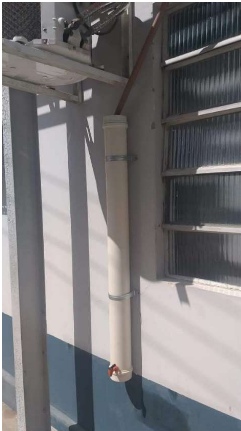
Figura 29 – Coletor para armazenamento/aproveitamento da água do ar-condicionado na Empresa “K”
