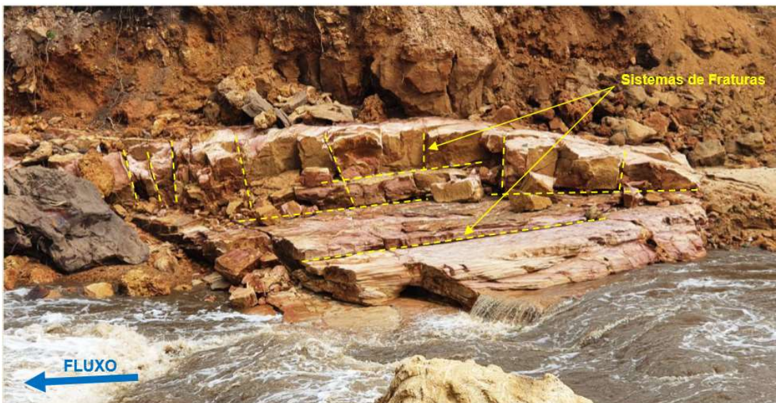
Figura 5.7 – Vista frontal do sistema de fraturas da rocha de fundação, extraído do Primeiro Relatório de Evolução das Anomalias.
