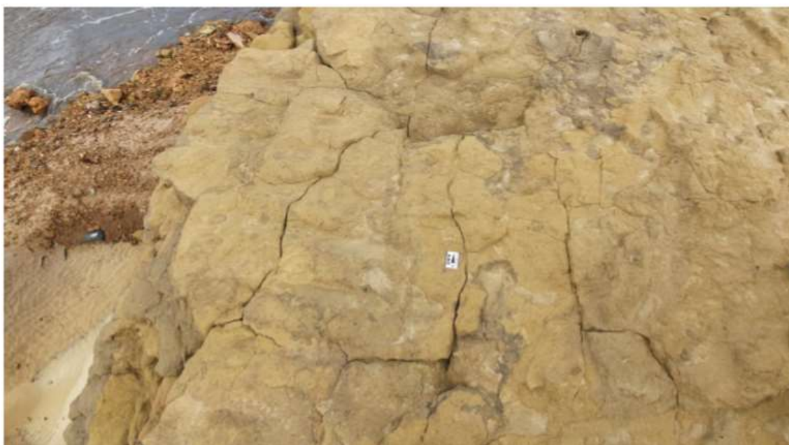
Figura 5.8 – Detalhe da superfície do solo compactado trincado proveniente da área de vedação à montante, extraído do Primeiro Relatório de Evolução das Anomalias.
