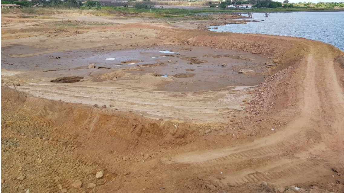
Figura 5.9 – Vista para montante com detalhe das cavidades formadas no tapete impermeável localizado à jusante da enseadeira.
