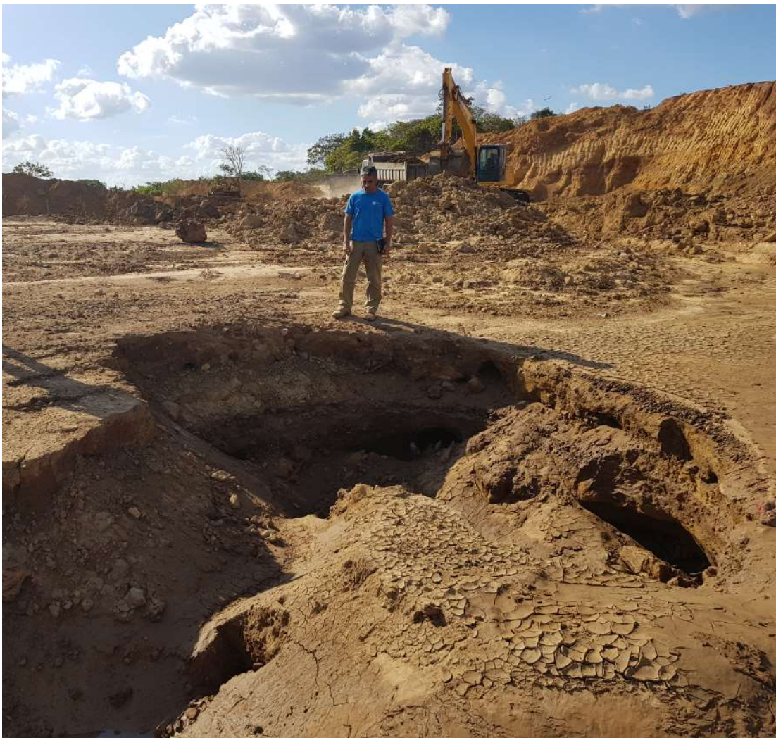
Figura 5.10 – Detalhe das cavidades observadas no tapete impermeável de montante.
