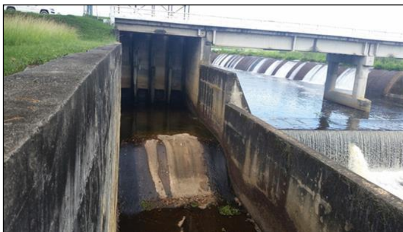
Figura 7 – Comportas do lado direito do vertedouro apresentando problemas de vedação
