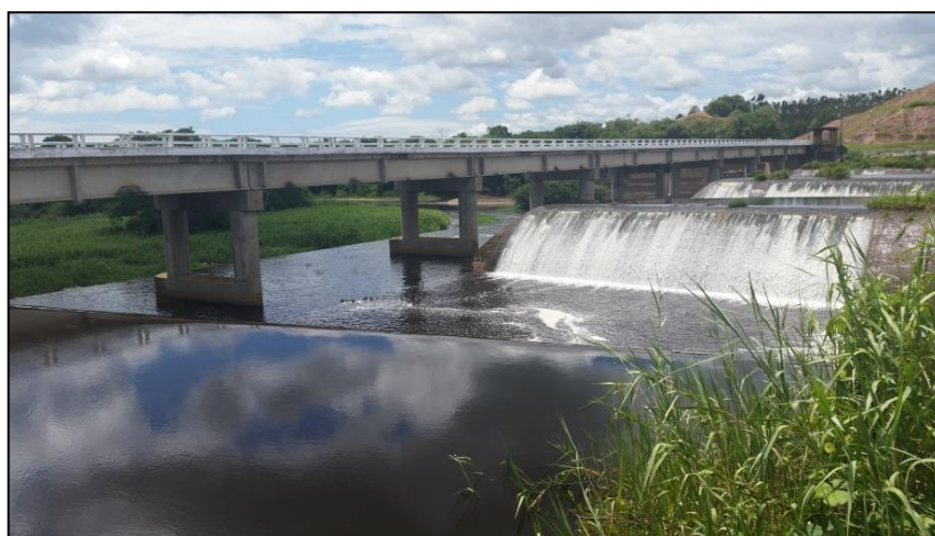
Figura 5 – Vista da ponte de interligação. Observar a vegetação resultante do processo de assoreamento a jusante da barragem e em frente ao vertedouro
