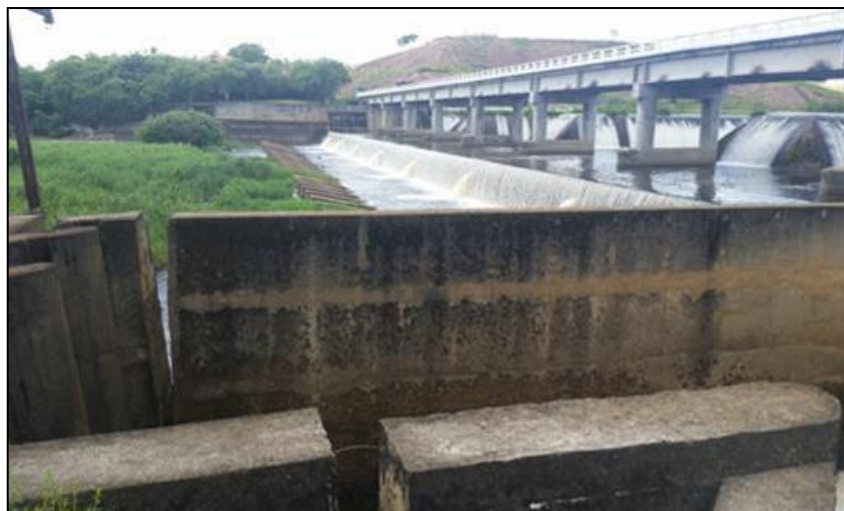
Figura 9 – Colapso do canal de restituição do lado esquerdo do vertedouro
