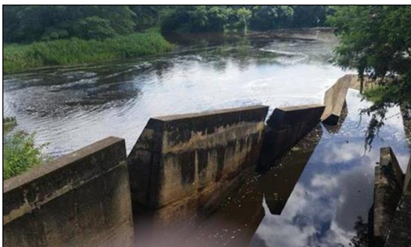
Figura 6 – Estrutura de concreto rompida do lado direito do vertedouro
