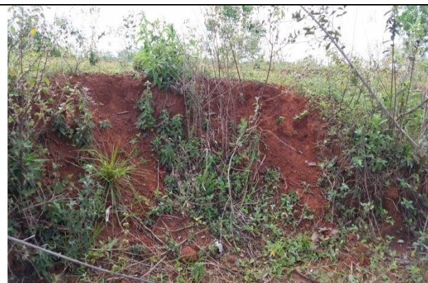
Figura 41- Erosão de talude de jusante
