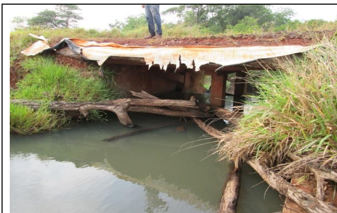
Figura 33- Obstrução com troncos
