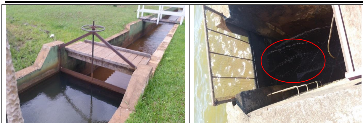
Figura 45- Problema de vedação da comporta
