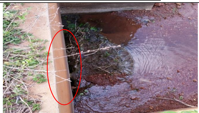
Figura 30 - Assoreamento do vertedor
