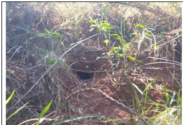
Figura 25- Toca de tatu no talude
