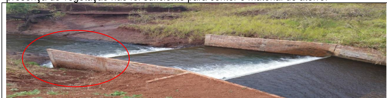
Figura 44- Erosão de contato do vertedor
