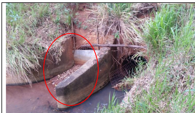
Figura 35- Obstrução com placa metálica
