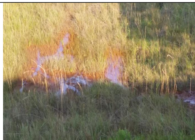
Figura 11- Presença de água no pé da barragem
