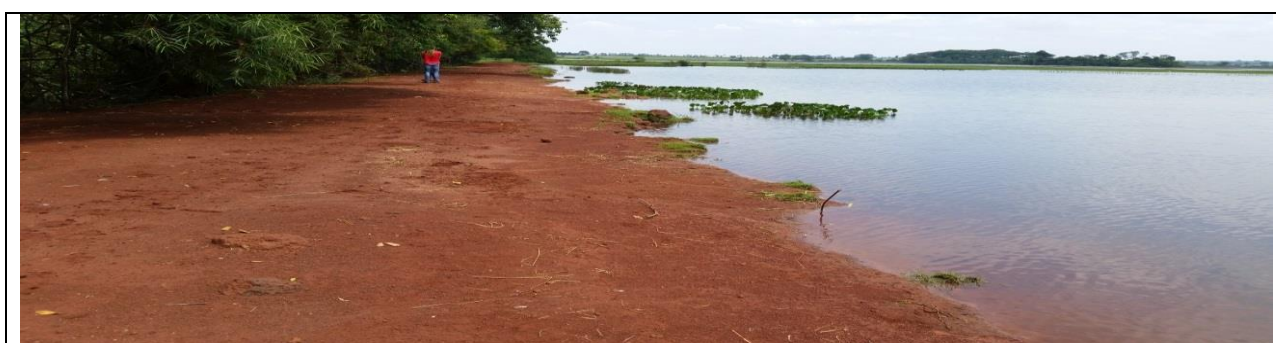
Figura 37 – Barragem sem altura de segurança (folga)
