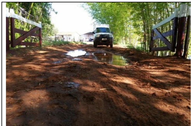
Figura 38- Empoçamento no coroamento
