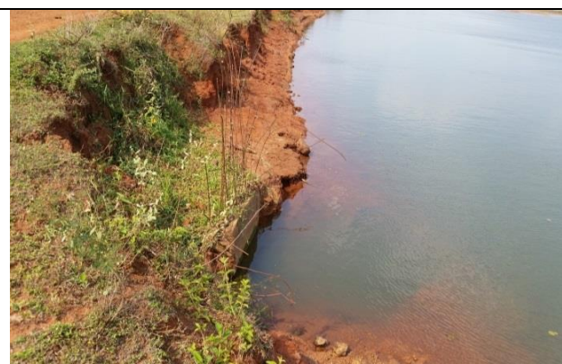
Figura 43- Erosão no talude de montante
