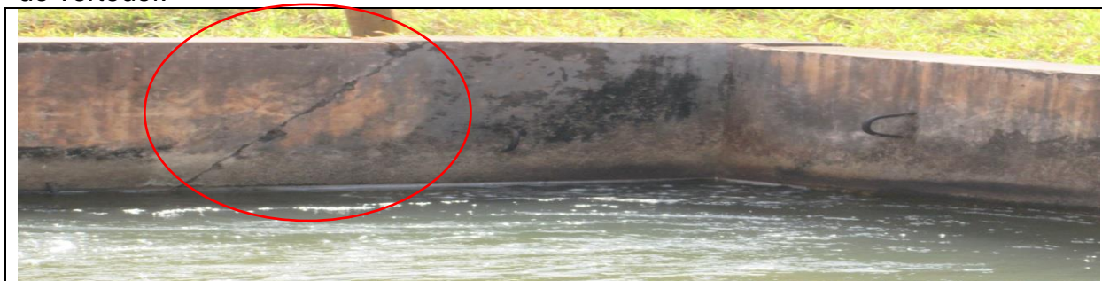
Figura 49- No detalhe, a trinca no concreto
