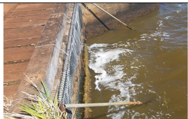
Figura 36 – obstrução da tela de proteção
