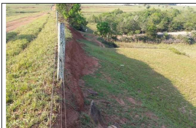
Figura 18 -Talude com áreas sem proteção
