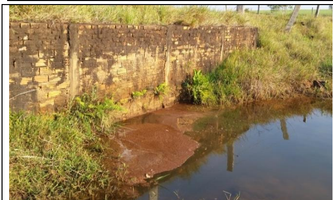
Figura 29- Assoreamento na barragem
