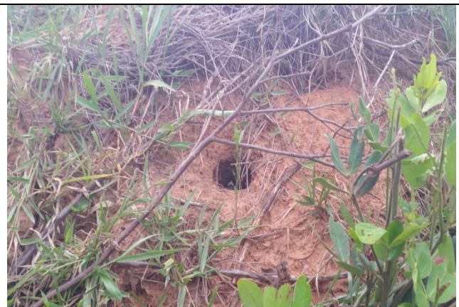
Figura 26- Toca de tatu no talude
