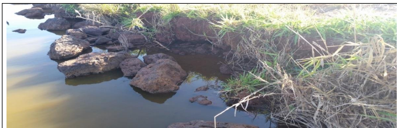
Figura 17 – Proteção inadequada em barragem
