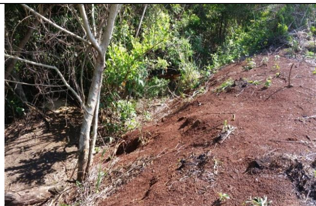
Figura 40- Erosão no talude de jusante
