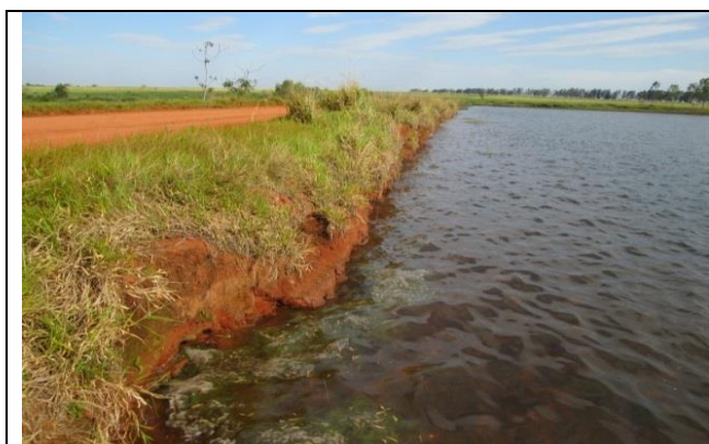
Figura 42- Erosão no talude de montante
