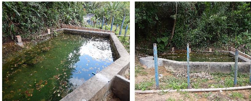
Figura 18- Fonte sem cobertura de alvenaria.
