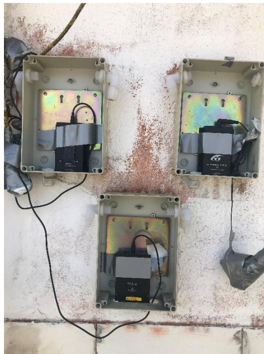
Figura 10: Monitores instalados na parede externa da Escola Municipal de Bananeiras, Ilha de Maré, Salvador-BA.
