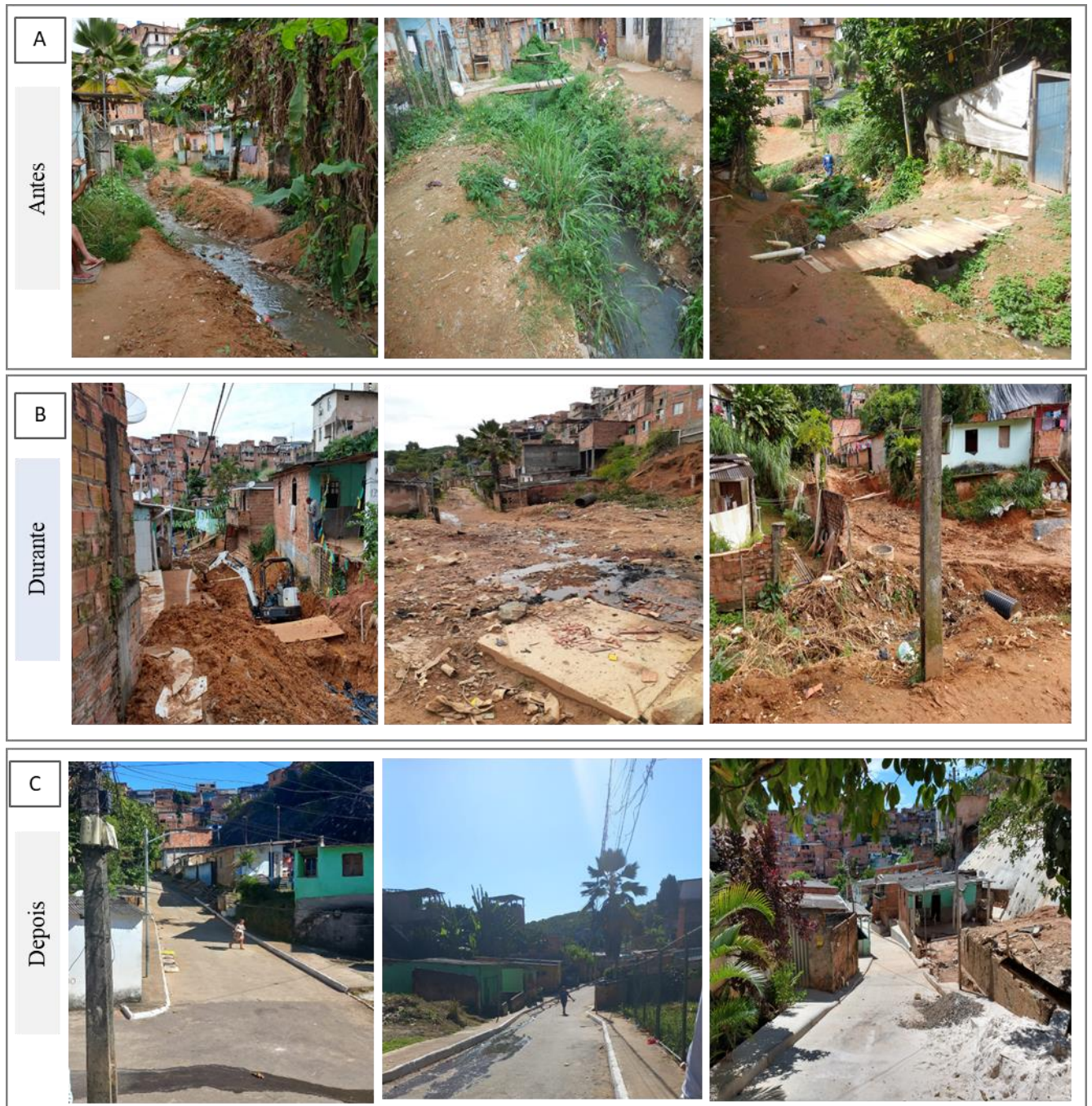
Fig. 2- Painel fotográfico da intervenção de canalização e tamponamento dos corpos d'água poluídos com esgoto doméstico no vale 2. As imagens em A - Antes da intervenção, B - Durante da intervenção e C - Depois da intervenção. A intervenções similares ocorreram no vale 3 em períodos diferentes.
