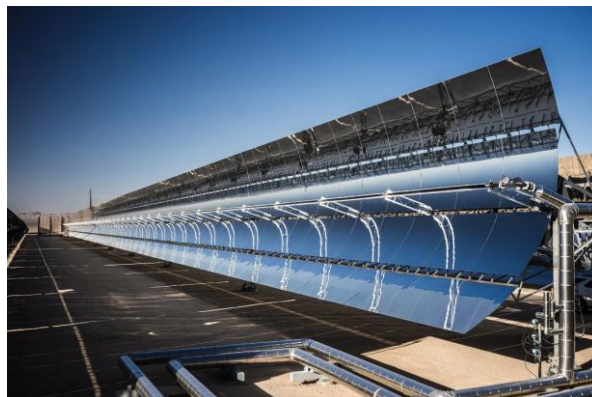
Figura 3.1 – Campo solar de calhas parabólicas da FLABEG FE GmbH instalado em uma planta CSP de 550MW na Arábia Saudita.
