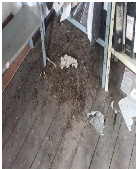
Figura 05 – Abandono da Biblioteca
