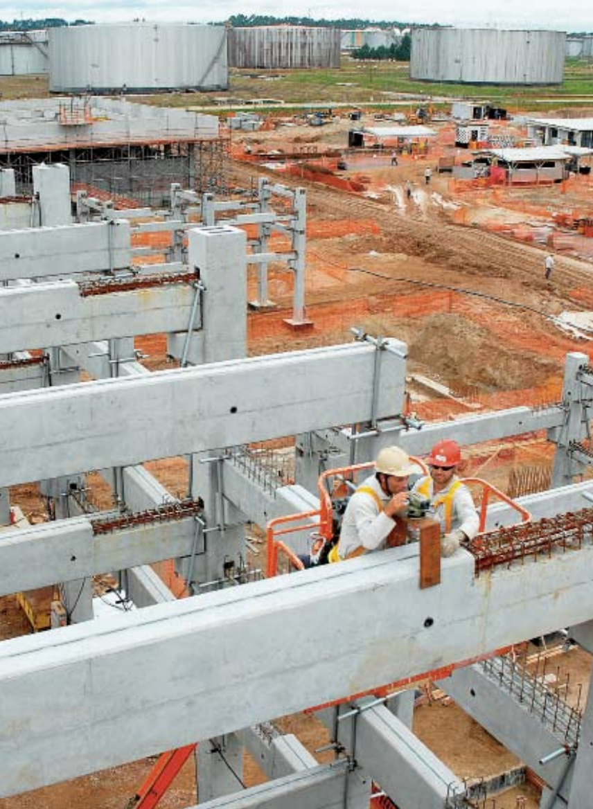
[ Obras na refinaria: realização simultânea do projeto executivo, da construção civil e da montagem industrial ]
