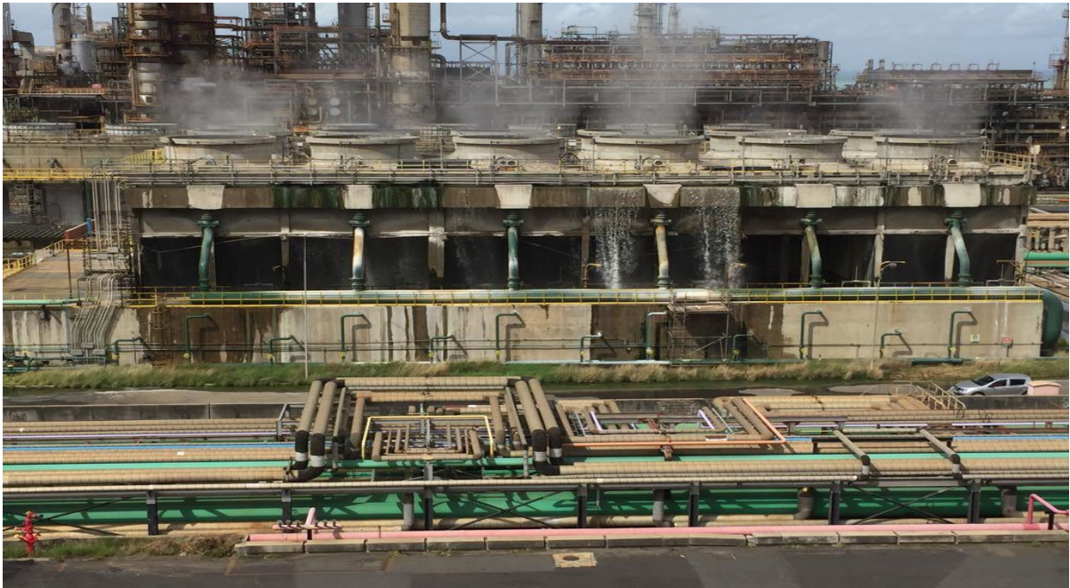
Figura 3.3 – Torre de resfriamento selecionada de uma refinaria do nordeste brasileiro.
