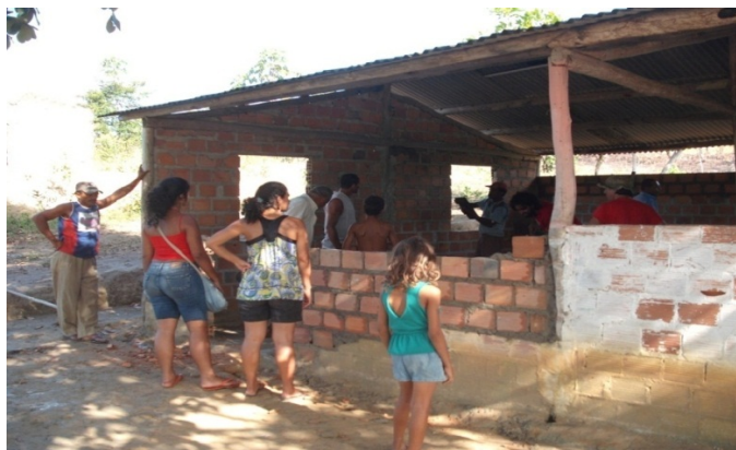
Foto da associação de moradores do Assentamento Nova Panema antes de serem levantadas as paredes.
