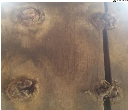
a) degradação de conectores metálicos e formação de fissura em ligação estrutural de madeira
