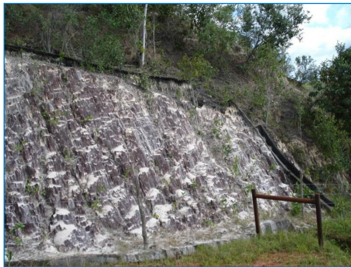
Figura 10 - Talude sub-vertical em faixa Fonte: Mapeamento Geoambiental - Ativo Sul, 2009
