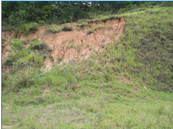
Figura 07 - Desbarrancamento e exposição de argissolo vermelho-amarelo em taludes sub-verticais, próximo a Catu, Bahia.
