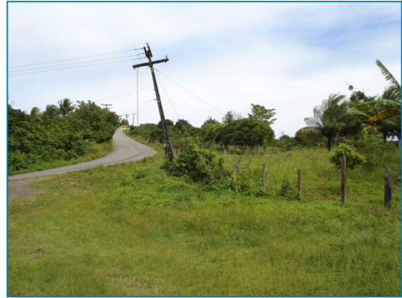
Figura 12 – Detalhe da inclinação de postes, em parte devido ao movimento do solo Fonte: Mapeamento Geoambiental - Ativo Sul, 2009
