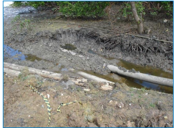
Figura 14 - Trabalhos de colocação de dutos sobre esses solos. Fonte: Mapeamento Geoambiental - Ativo Sul, 2009
