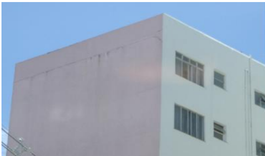
Figura 2.4. Fissuras causadas por variação térmica
