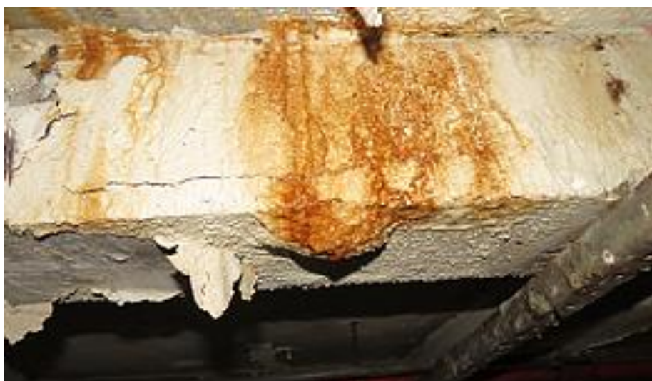
Figura 2.5. Fissuras causadas por degradação do concreto
