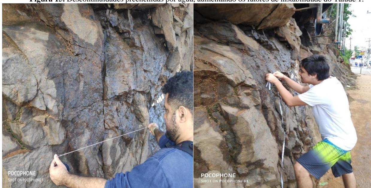
Figura 15. Descontinuidades preenchidas por água, aumentando os fatores de instabilidade do Talude 1.
