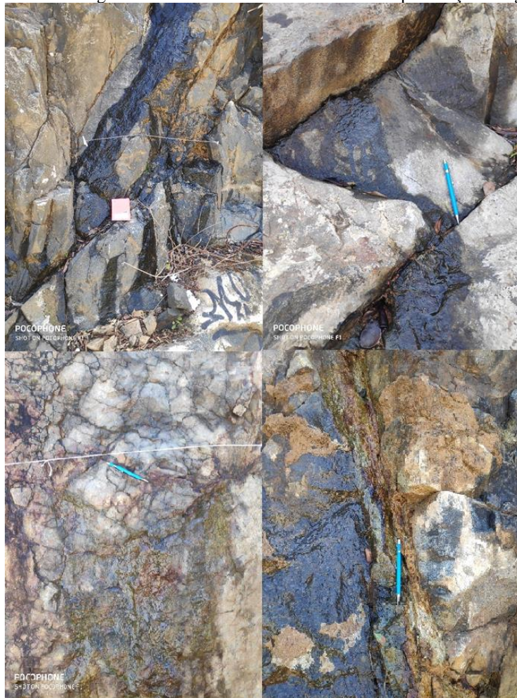
Figura 28. Mosaico de fotografias mostrando descontinuidades com percolação de água no Talude 2.
