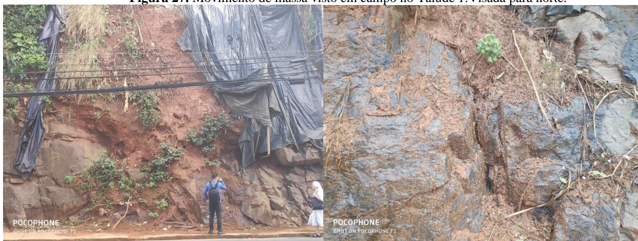
Figura 27. Movimento de massa visto em campo no Talude 1. Visada para norte.
