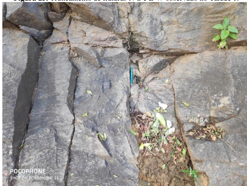
Figura 25. Truncamento de fraturas N-S e E-W observado no Talude 1.
