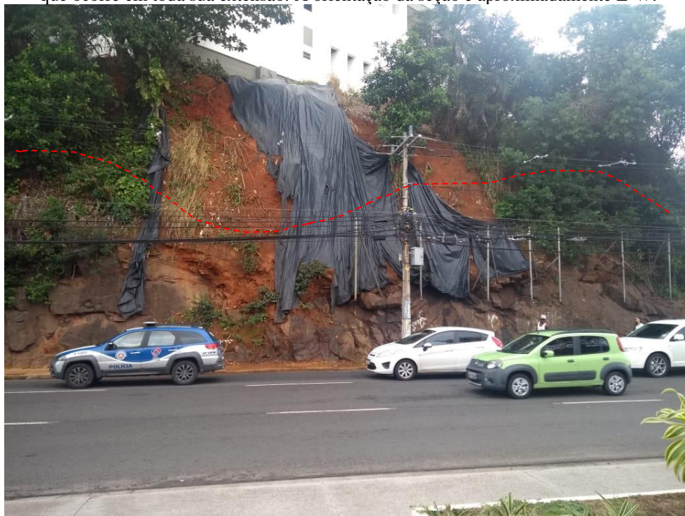
Figura 18. Fotografia do Talude 1, localizado no bairro do Rio Vermelho, com destaque zona de cisalhamento que ocorre em toda sua extensão. A orientação da seção é aproximadamente E-W.
