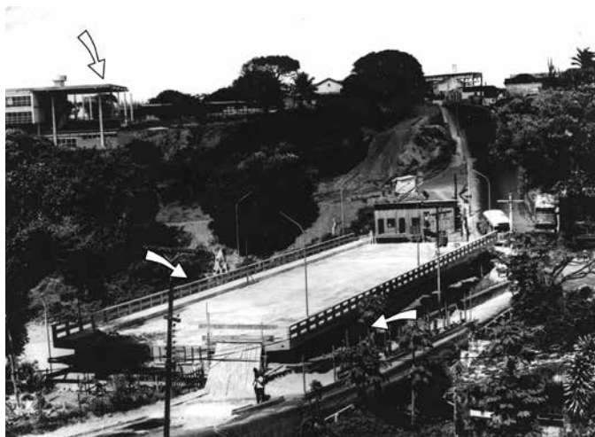
Figura 9 – Construção do Viaduto General Mascarenhas de Moraes, junto ao 2º Arco, vendo-se a parte superior de ambos. No alto, a Faculdade de Arquitetura da UFBA
