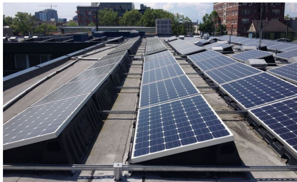
(c) Painéis fotovoltaicos em um prédio comercial
