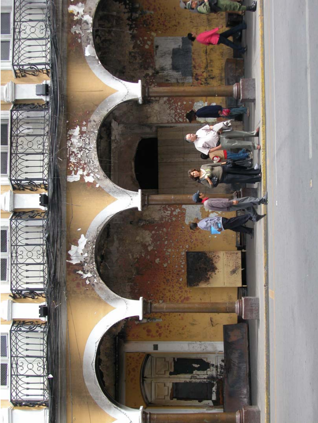
Fachada da Prefeitura de Cochabamba, incendiada durante o conflito entre a juventude cruceña e grupos indígenas, no dia 11 de janeiro de 2007
