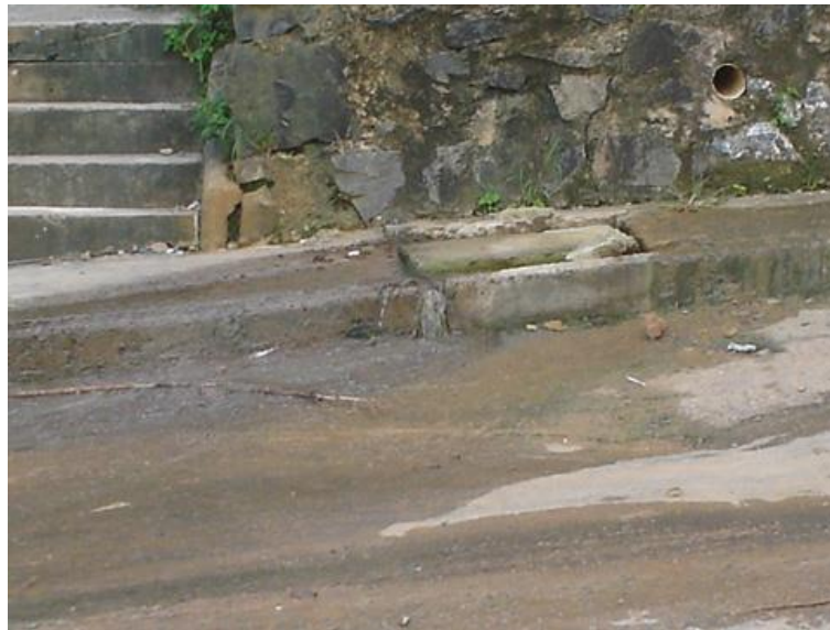
Figura 22: Rua com problemas de saneamento básico no bairro do Lobato, 2009.
