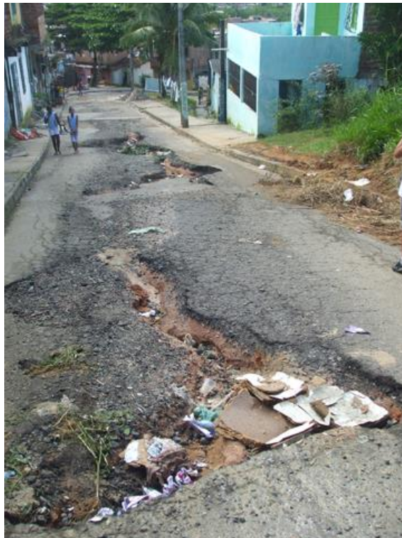
Figura 26: Asfalto deteriorado numa das ruas do bairro do Lobato, 2009.
