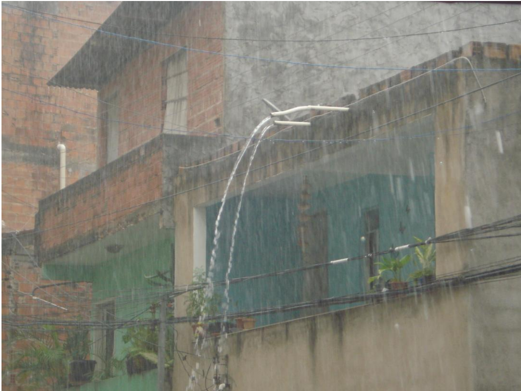
Fig. 11 - Problemas de Manejo das Águas Pluviais
