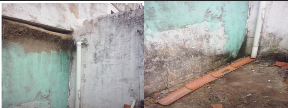
Fotos da questão em evidência que mostra a interface entre a parede da Sra. M. Lúcia e o tubo de escoamento do telhado do vizinho fixado na fachada do mesmo
