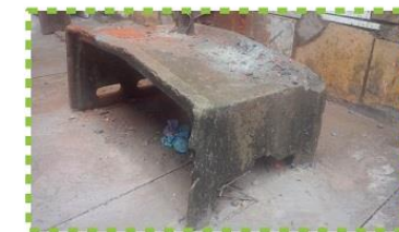
Placa de rampa drenantes que foi removida do local. (Fonte: acervo pessoal)
