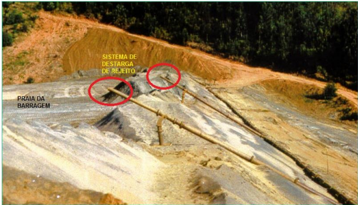
Figura 3 – Disposição de rejeitos através do método de aterro hidráulico em uma barragem de alteamento a jusante.
