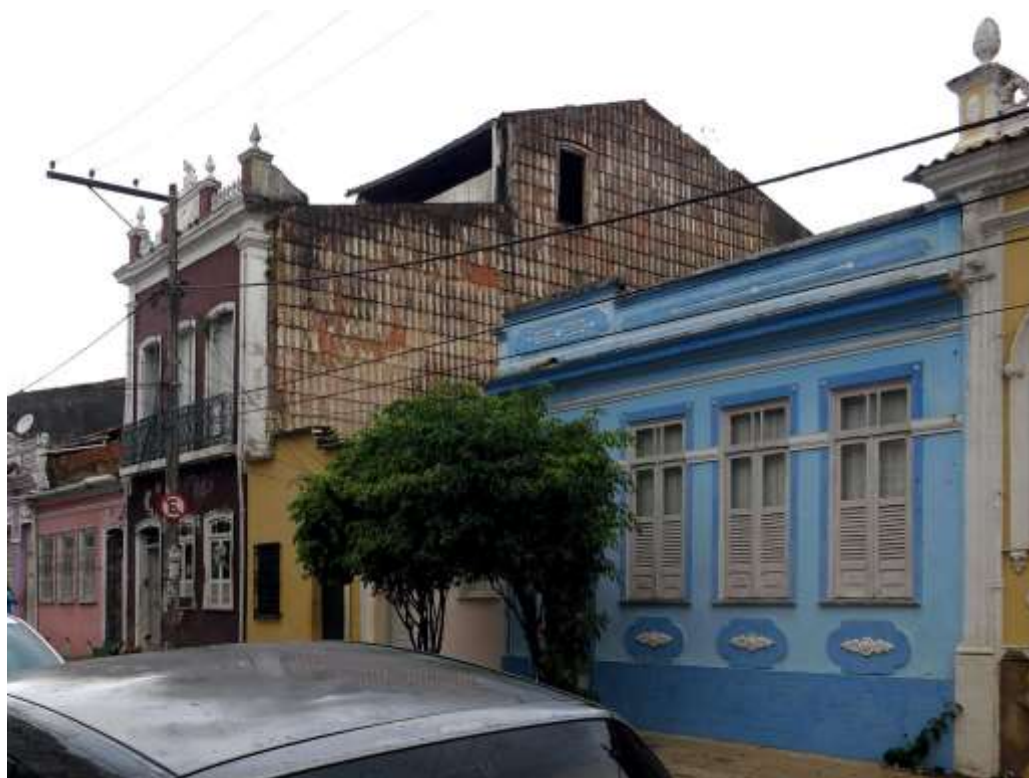
Figura 158 | Vista de sobrado na Rua Direita de Santo Antônio, em Salvador. A empena revestida em telha cerâmica canal apresenta perda de consistência física do seu tratamento de superfície, devido ao descolamento de telhas, além de áreas enegrecidas pela presença de biofilme. Paralelamente, considera-se que a introdução de um piso suplementar recuado com relação à fachada principal, através da criação de um plano vertical envidraçado e um terraço, produzem um impacto negativo na morfologia da empena lateral e, conseqüentemente, na morfologia do próprio sobrado. (foto do autor, nov./2016)
