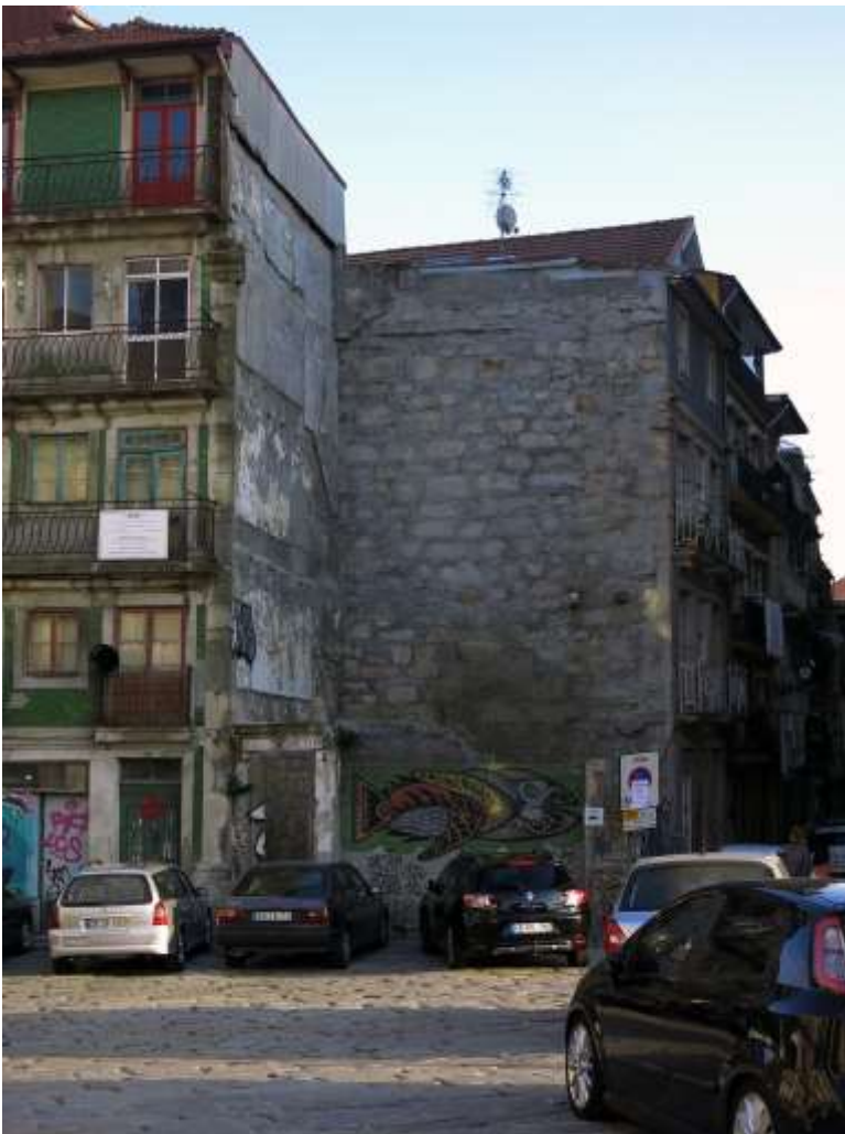
Figura 179 | Vista a partir da Rua Campo Mártires da Pátria em direção à Rua São Bento da Vitória. Devido à derrocada do edifício no canto da quadra, as duas empenas laterais dos edifícios adjacentes adquiriram visibilidade e, em função da sua dimensão e relação com a paisagem urbana, apresentam um protagonismo significativo. De acordo com as categorias propostas no presente trabalho, considera-se que se tratam de duas empenas fragilizadas. (foto do autor, ago./2017)
