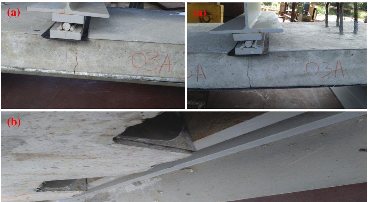
Figura 86: Fissuras (a) e deslizamento relativo(b) após ruptura da amostra RM75-03 A.
