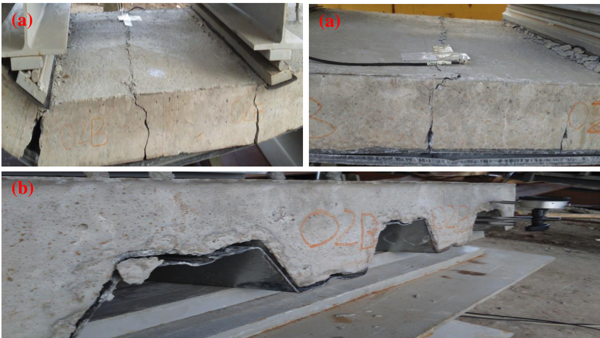
Figura 77: Fissuras (a) e deslizamento relativo (b) após ruptura da amostra RM75-02B.
