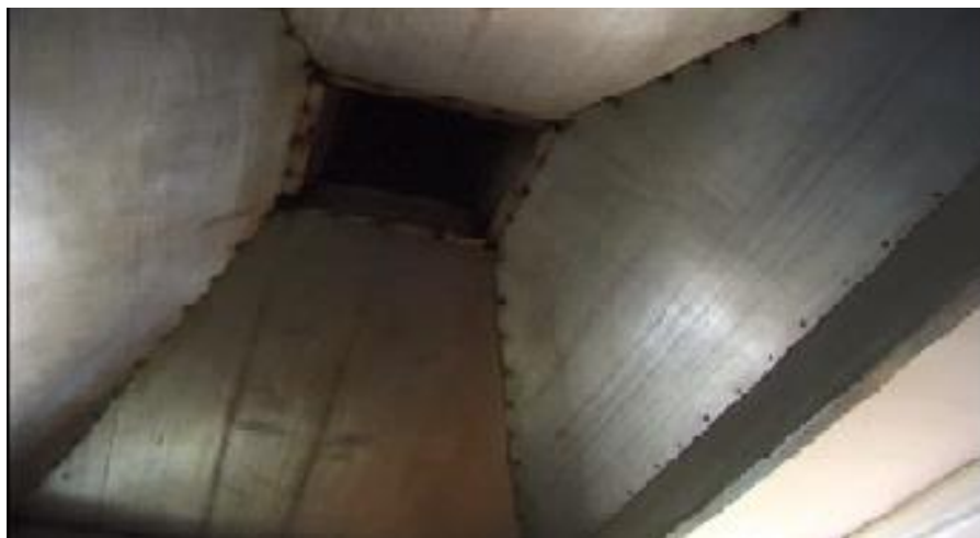
Figura 3.40 - Exaustor industrial na cozinha da Zanon (29:40).
