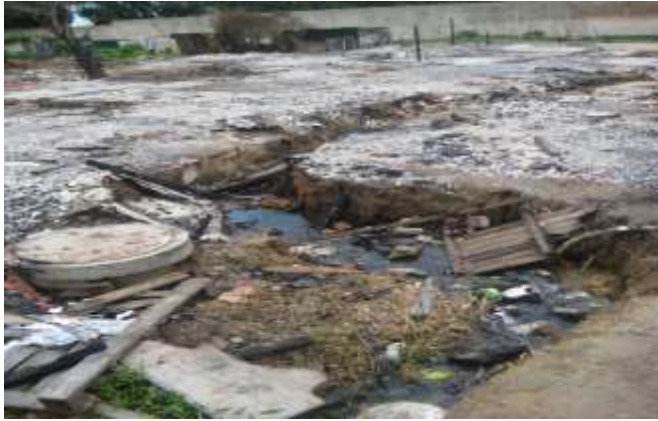
Figura 4 - Esgoto na Ocupação Quilombo de Escada, do MSTB
