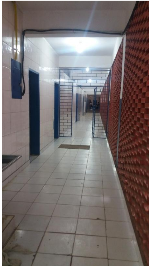
FIGURA 8 – Corredor de salas de aula da Escola Estadual em Feira de Santana. Foto feita pela autora.
