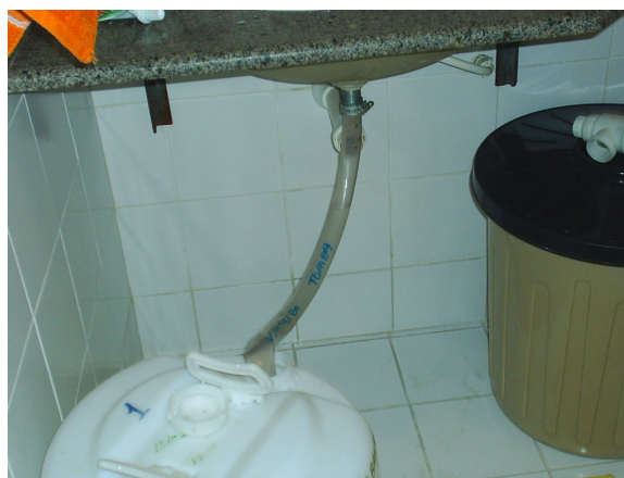
Foto 9: Coleta no lavatório.
