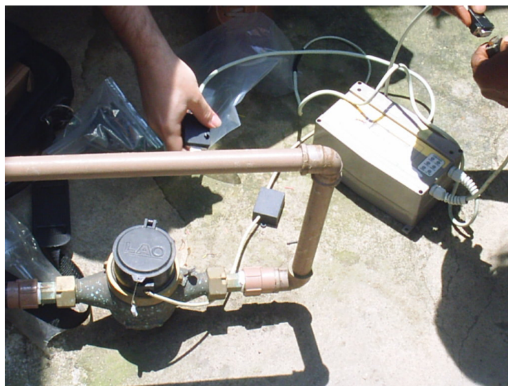
Foto 15: Hidrômetro e datalogger instalados.
