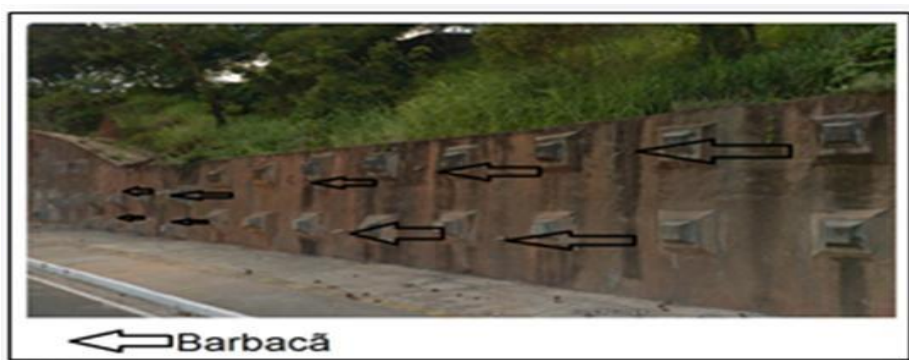
Figura 49. Barbacãs (dreno de pvc colocado nas encostas)
