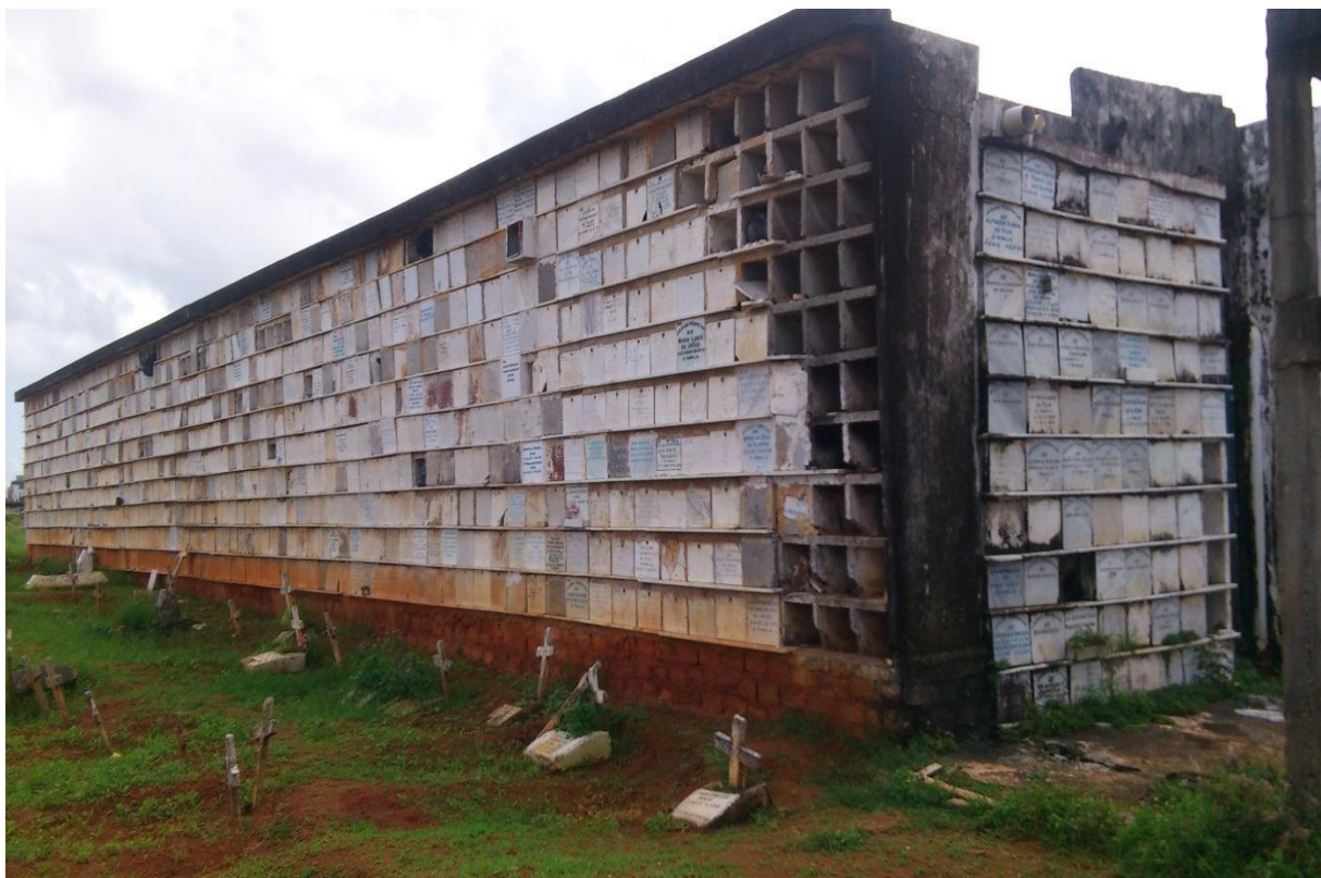
Figura 73. Ossuário em péssimo estado de conservação, deixando ossos expostos a ratos e vetores de doenças.
