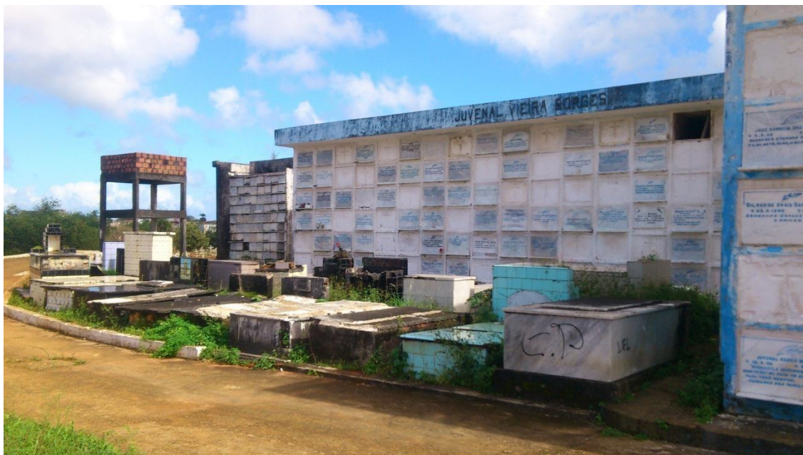
Figura 76. Campas em estado deplorável no interior do cemitério Quinta dos Lázaros.
