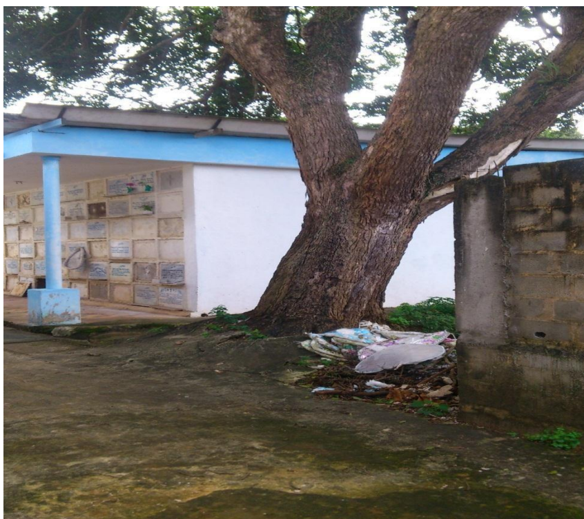
Figura 70. Arvore de raiz radicular deteriorando o piso e arruamento do cemitério Quinta dos Lázaros. Logo no seu entorno restos de exumação.
