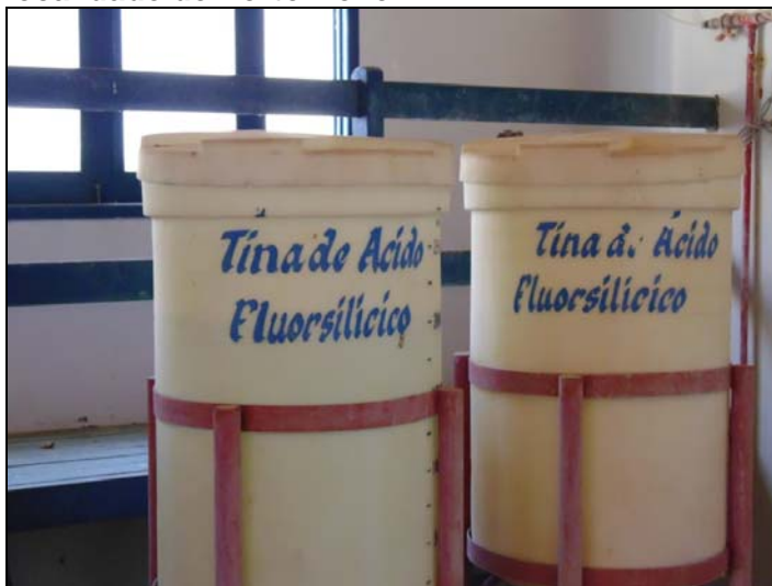
Foto 6 - Dosadores de ácido fluorsilícico da estação de águas de abastecimento na localidade de Porto Novo.
