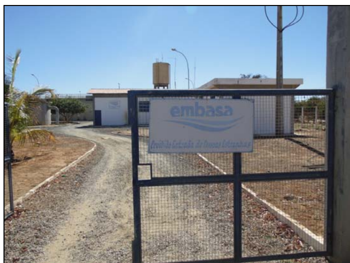
Foto 5 - Sistema de captação e tratamento de água na localidade de Porto Novo
