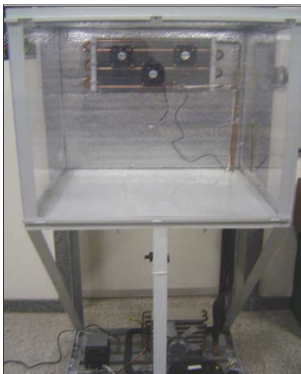
Figura 74 – Unidade condensadora para câmara climatizadora e seu controlador eletrônico.
