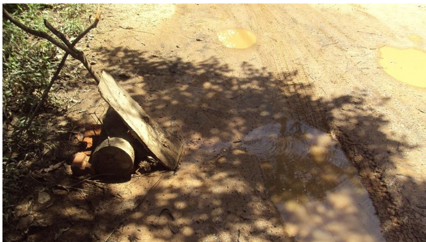
Figura 6: Proteção improvisada para vazamento de água (rompimento de tubulação) na estrada que vai até o Bomba
