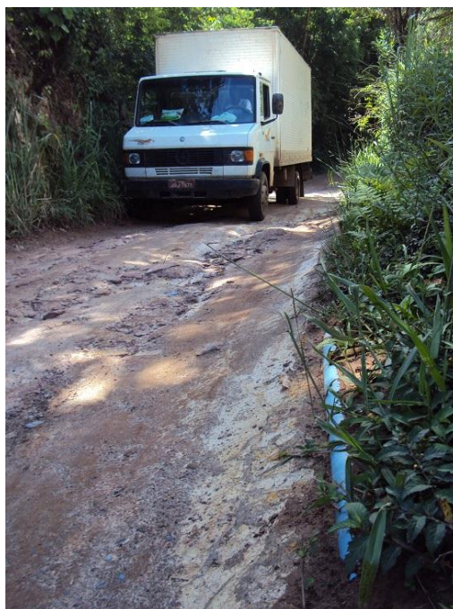
Figura 7: Tubulação aparente próximo ao Rufino Rocha
