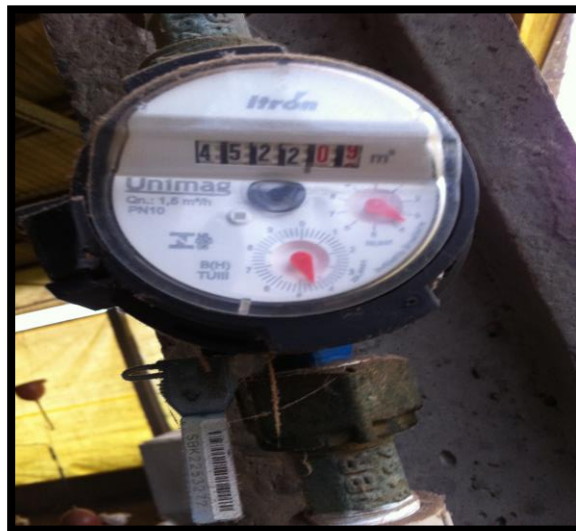
Ilustração 6 - Hidrômetro que fornecia dados referente ao consumo diário de água nos galpões. Fonte: Acervo pessoal
