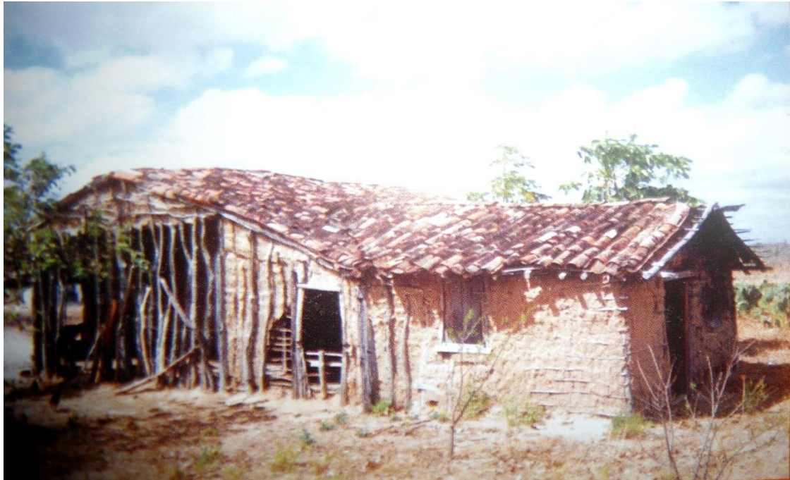
Fig. 29 – Degradação da Casa de Maria Bonita ( In : LIMA; MARQUES, 2006).
