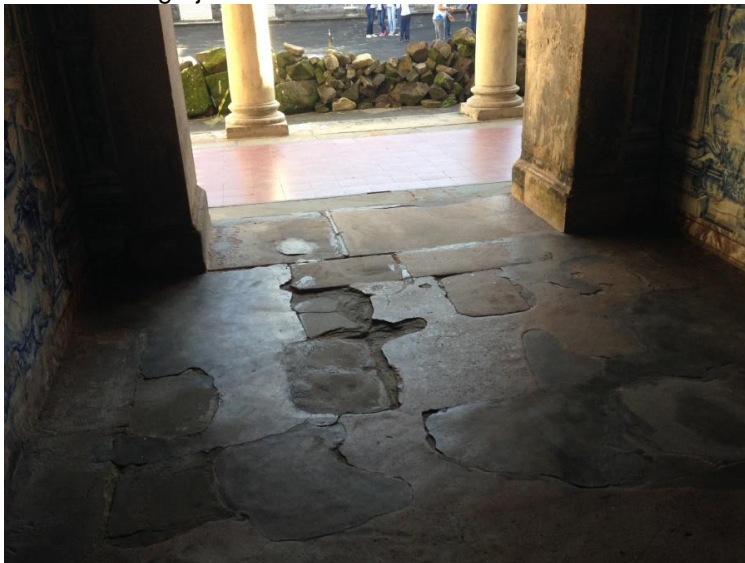
Figura 99: Igreja de São Francisco – Piso danificado da área de acesso à sacristia e à Igreja
