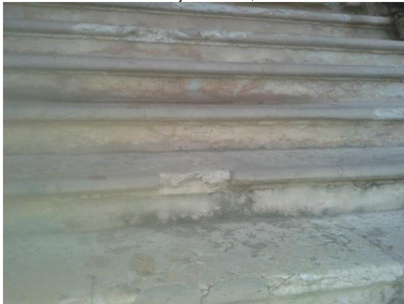
Figura 55: Solar Ferrão – detalhe – degrau danificado da escadaria de acesso à Praça das Artes, Cultura e Memória
