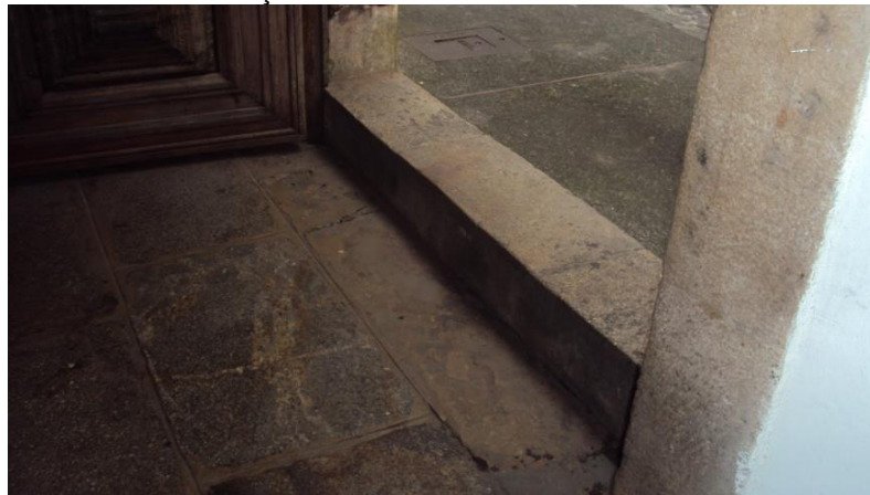
Figura 30: Galeria Solar Ferrão – entrada de visitantes – desnível entre calçada e área interna.
