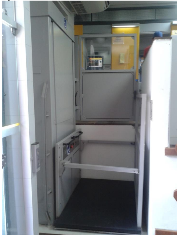
Figura 23: elevador para acesso de deficientes físicos, instalado no imóvel sito à Praça Anchieta, 13. Agência do Banco do Brasil – Salvador – BA.
