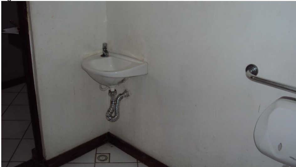
Figura 44: Solar Ferrão – sanitários acessíveis – lavatório sem coluna
