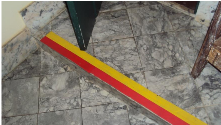
Figura 76: Praça Anchieta, nº 18, Hotel Villa Bahia. Desnível do sanitário masculino
