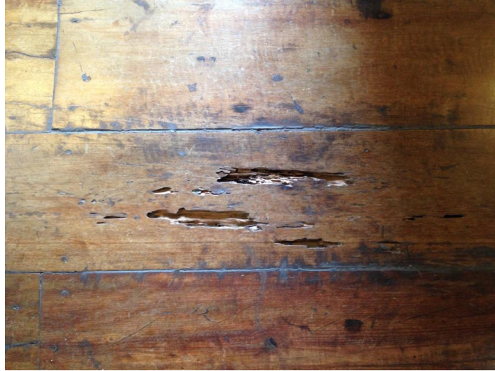
Figura 35: Solar Ferrão – trecho danificado do piso do pavimento entressolho
