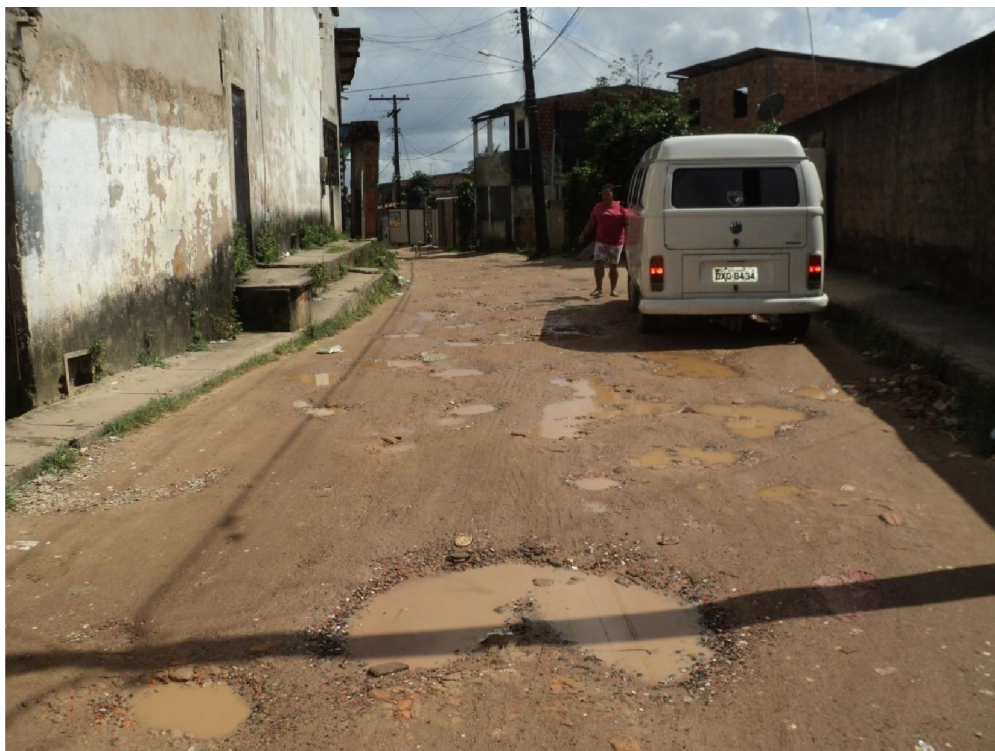
Foto 6 – Rua sem pavimentação. Fonte: Trabalho de Campo, 2013.
