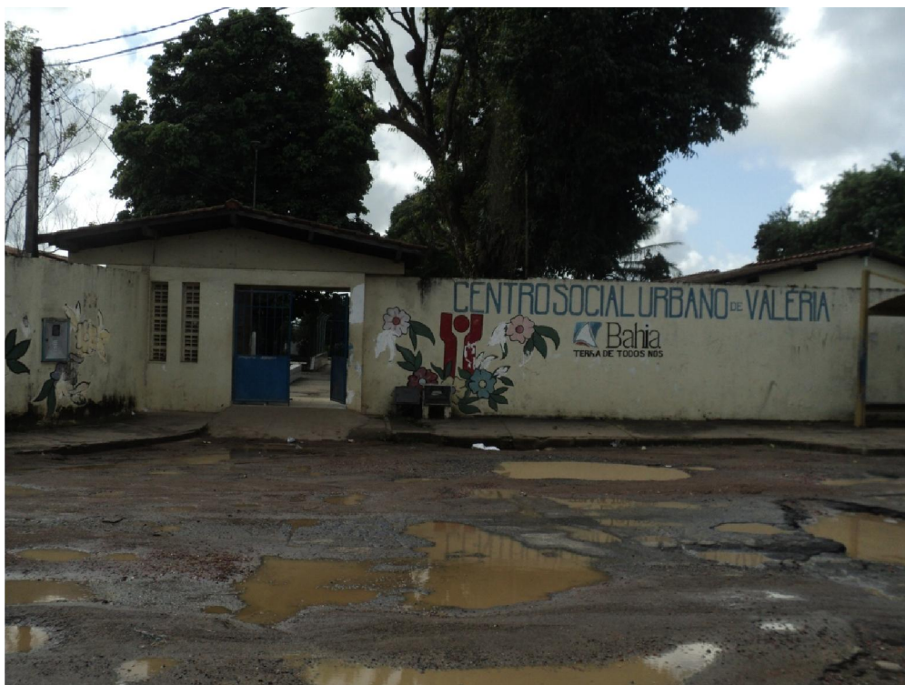
Foto 7 – Asfalto danificado. Fonte: Trabalho de Campo, 2013.
