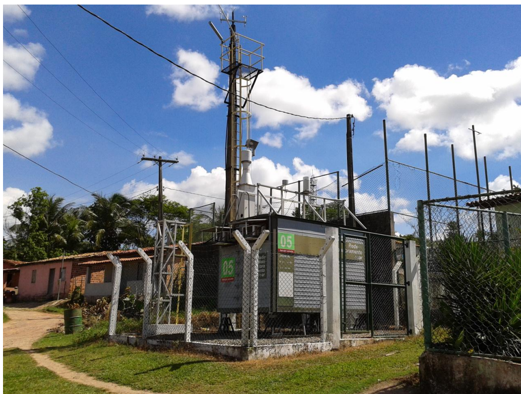
Figura 5: Estação 5 da Rede de Monitoramento do Ar da Cetrel, na localidade de Lamarão do Passé, 2012.
